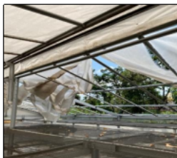
(A) Kerusakan green house akibat curah hujan
