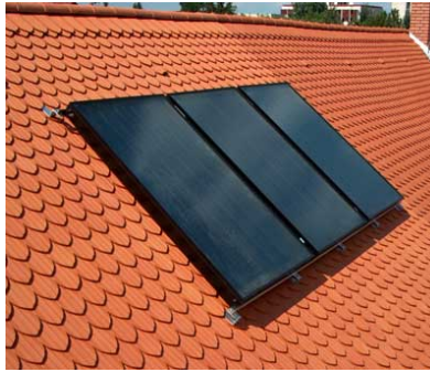
Gambar 2.4. Kolektor plat datar terpasang pada atap rumah
